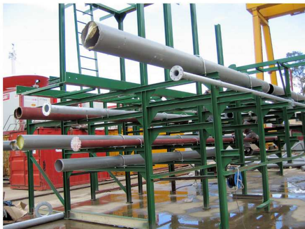
Módulo de Tubos
